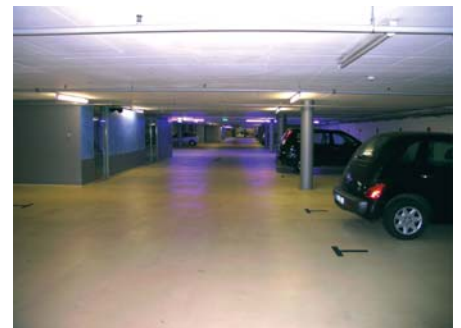
Abb. 13: Fußbodenbeschichtung in einer Tiefgarage mit guter Reifenfestigkeit
